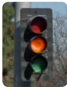
New traffic signals Semáforos nuevos 新交通信號
